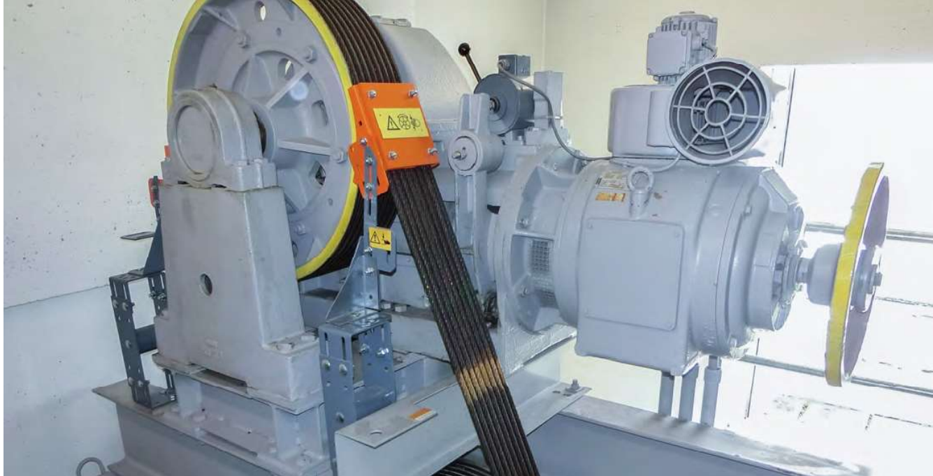
Alt: Antriebstechnik mit Getriebe und Stahlseilen
